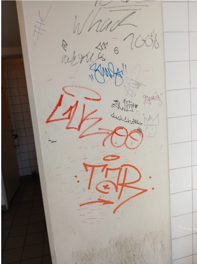
WC Anlage „Marktplatz“
